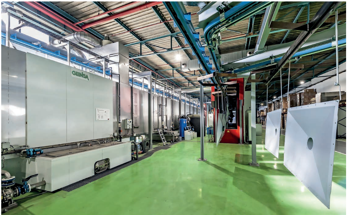
Vista general de la línea de tratamiento y secado.
