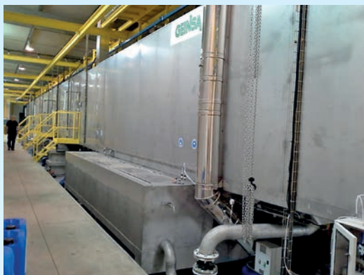
Túnel de tratamiento
