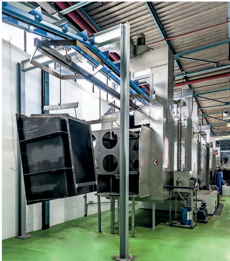
Vista general del túnel de tratamiento
