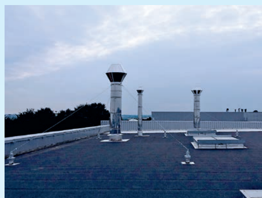
Conductos de extracción
