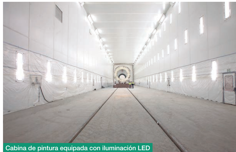
Cabina de pintura equipada con iluminación LED
